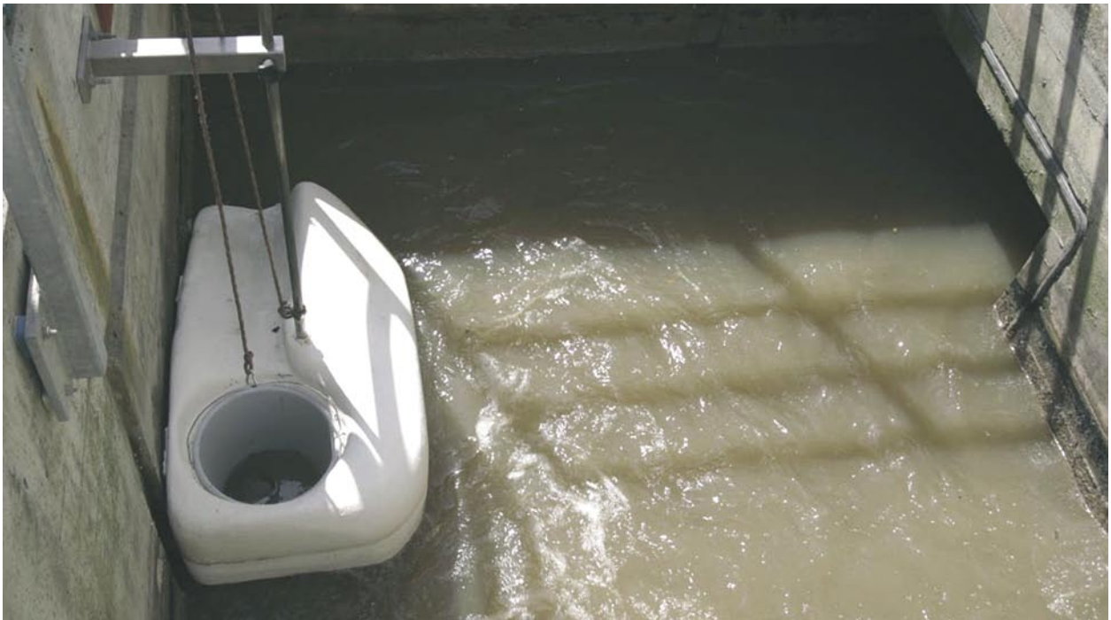
Abb. 9 Amphibien-Leiter im Entwässerungsschacht
