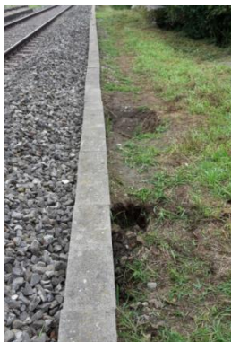
Gaben durch Biber und Dachs
