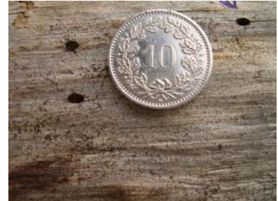
Trous photo S. Barbalat Ausbohrlöcher Fori
